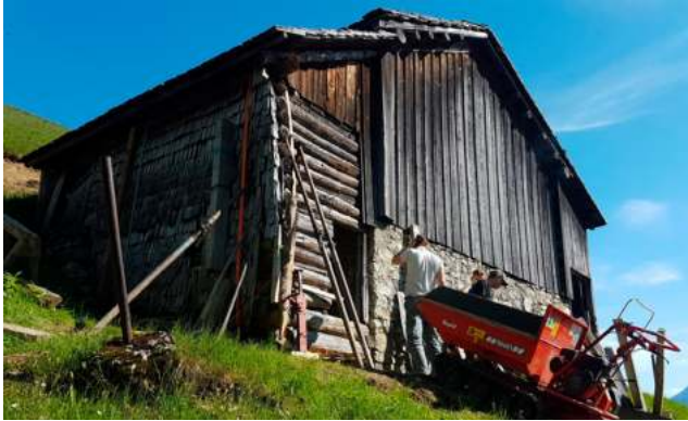
Schärätürlistall vor der Sanierung
