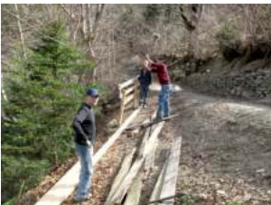
Winterschäden an Zaun beheben
